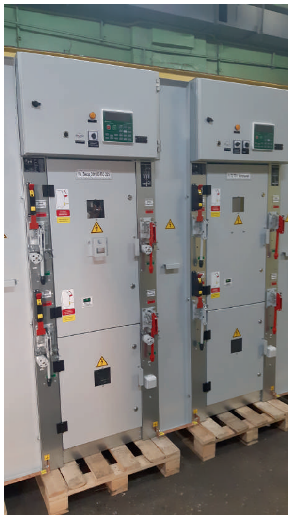
Отдельные двери высоковольтного отсека и отсека присоединений
