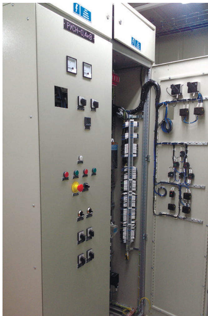
Шкаф РУСН в модуле СКП
