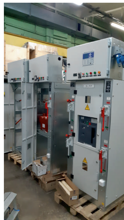
Высоковольтный отсек с выключателем VF-12
