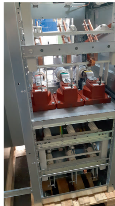
Металлическая перегородка между отсеком присоединений и высоковольтным, проходные ТТ
