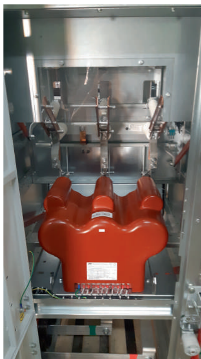
Высоковольтный отсек с измерительным ТН НАЛИ-НТЗ
