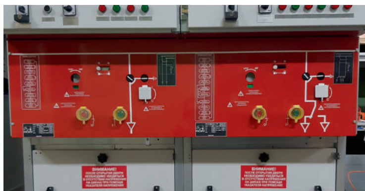
Закрытая панель отсека привода
