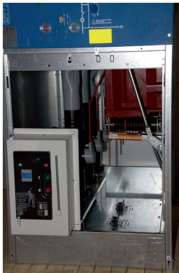
Отсек с силовым выключателем и ТТ
