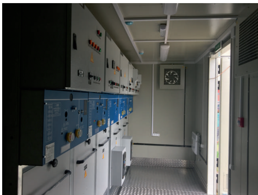
КСО «Горизонт -35» в модульном здании СКП
