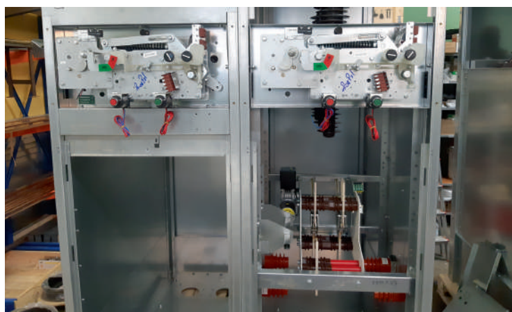
Отсек привода без фасадной панели
