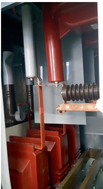
«Горизонт-35» ширина 1500 мм Установка ТН до ввода, ОПН, ТТНП
