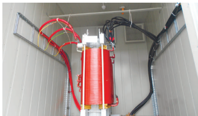
Понижающий трансформатор ТС 400кВА 10/0,4кВ
