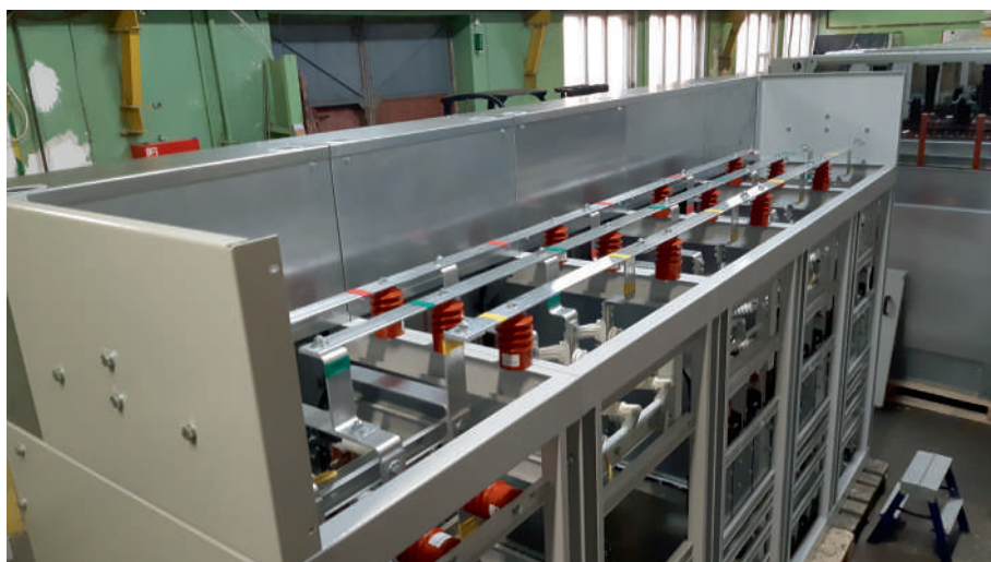
Открытый отсек сборных шин, боковые защитные перегородки
